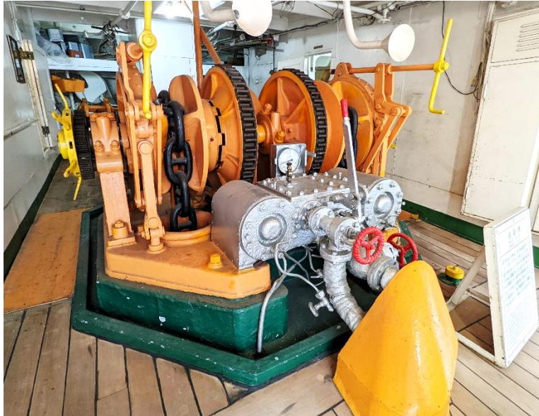
現在の日本丸の投錨機
