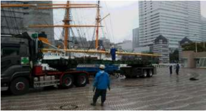
工事名： 帆船日本丸LGヤード改修工事 工程名： 製品搬入 撮影日時： 2021年3月8日
